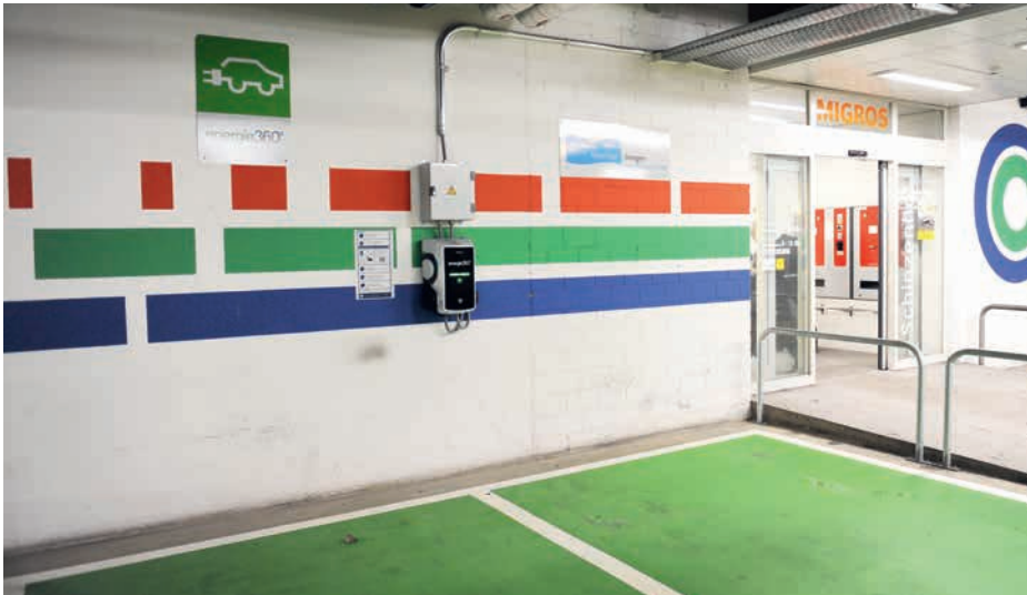
Eine Ladestation in der Tiefgarage.
